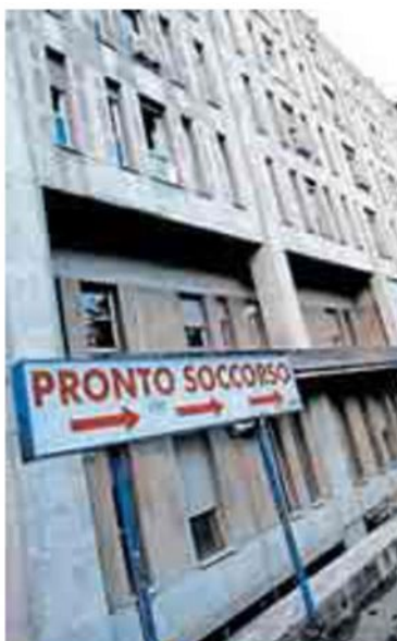
Allarme Il San Giovanni Bosco; sopra i locali invasi dalla pioggia
